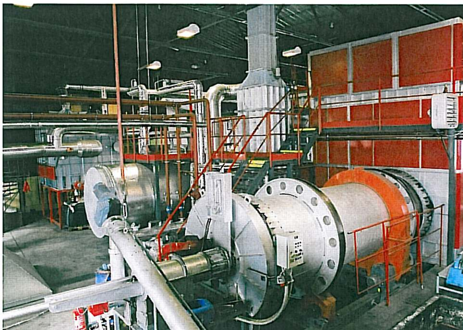
OBR. Pohľad na technologické zariadenia
